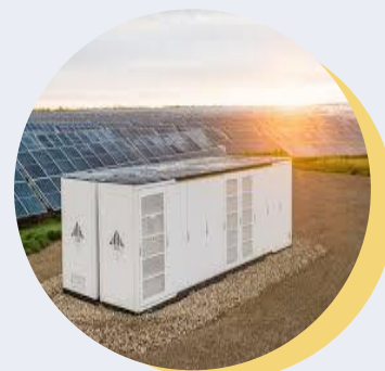
バッテリー エネルギー貯蔵システム (BESS)
